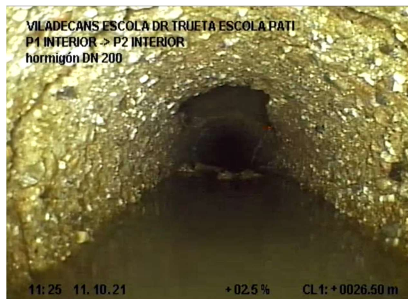
Imatge 1. Trencament col·lector existent
