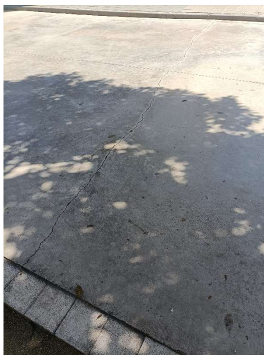
Imatge 4. Paviment de formigó fissurat.
