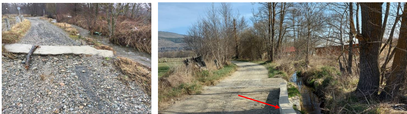
Punto 1: Izquierda vista de daños en el camino Ral por desbordamiento de la cañada de Saga, febrero de 2020, derecha, vista de camino reparado y mampostería de contención de caudales.
