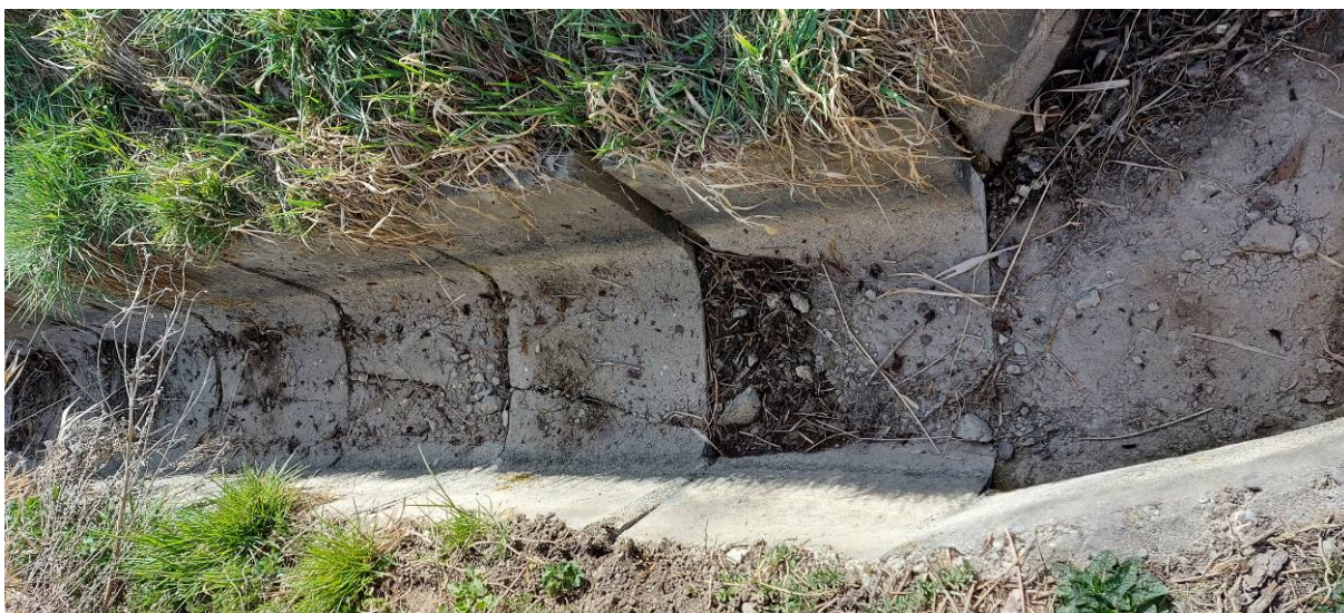
Vista de roturas localizadas de cuneta prefabricada existente en tramo de punto 2 a punto 3, de 85 m de longitud.
