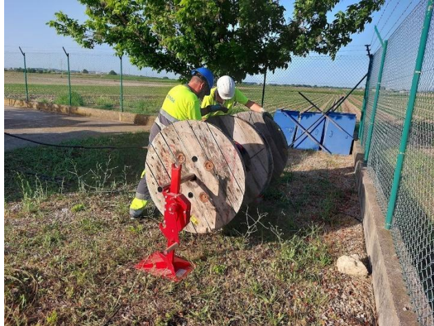
Imatge 2. Rul·los per al cable elèctric
