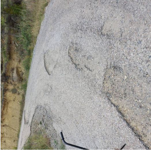
Fotografia núm. 33 : pK 1+845, paviment en revolt núm. 2, longitud 17 m.
