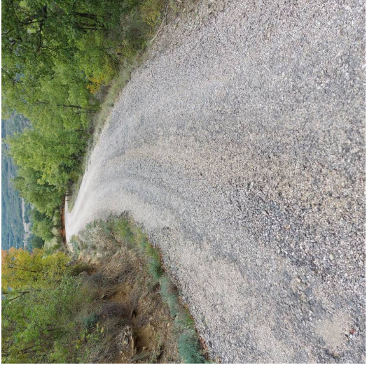
Fotografia núm. 57 : pK 2+274, longitud 19 m.
