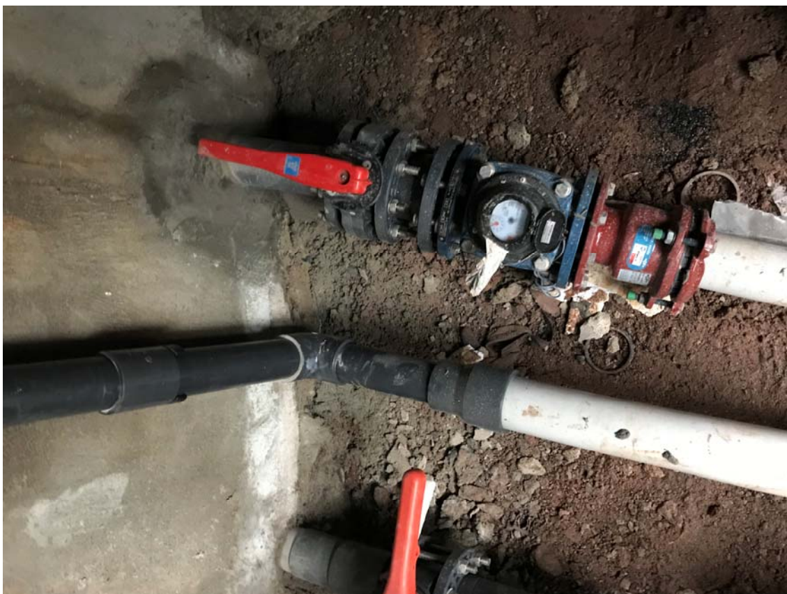
Fotografia del comptador a la sortida del dipòsit de Baro. Arxiu tècnic municipal 20/01/2018. Actualment Baro compta amb dos dipòsits de regulació de 60 m3 cadascun amb un total de 120 m3.
