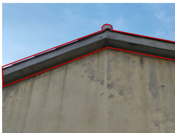
Figura 36: Fotografia del nou ràfec on caldrà aplicar la capa d'acabat de façana. Font: Diputació de Barcelona
