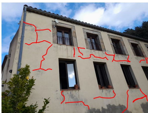
Fissures façana sud-est edifici A
