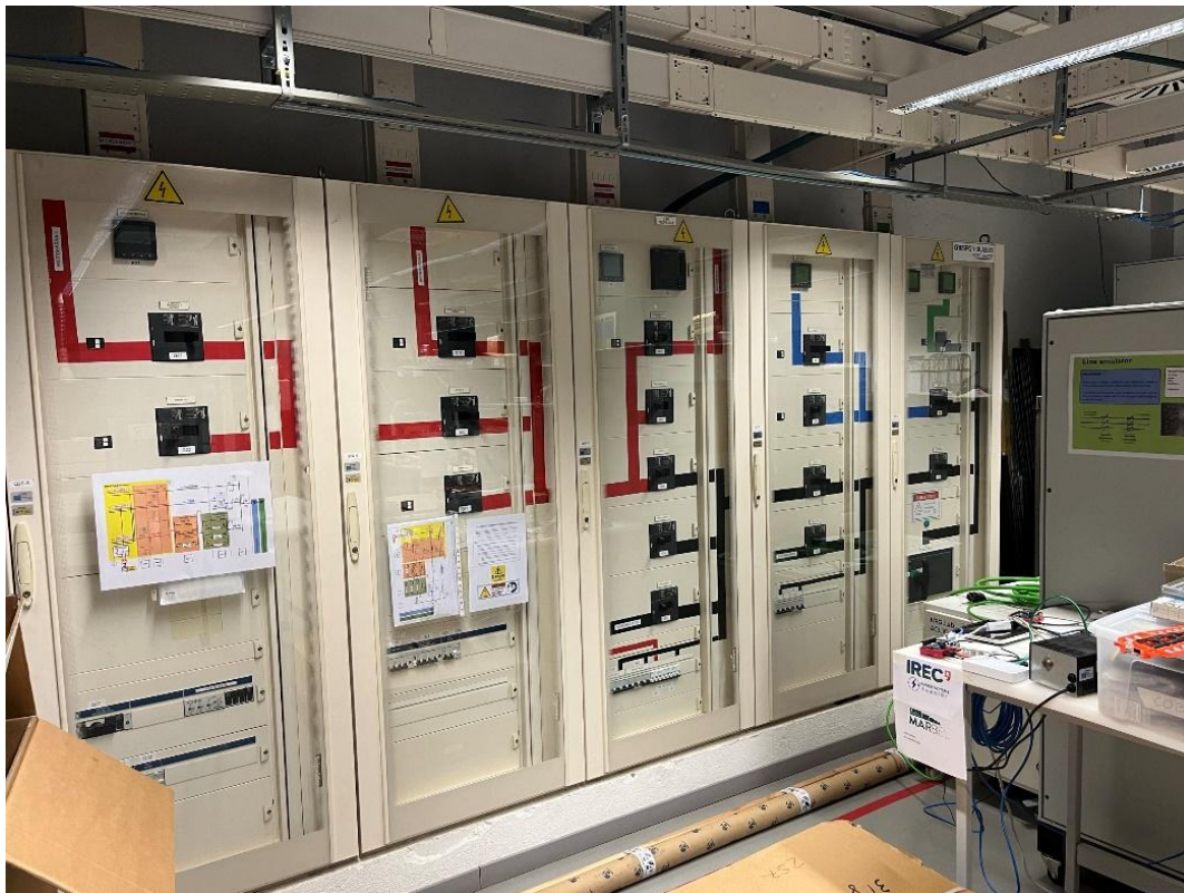
Fig. 3 - Armari elèctric Q26
