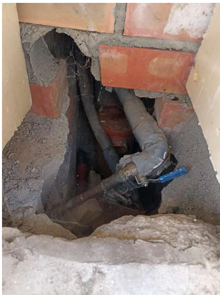
Figura 7. Arqueta de paret, en estat deficient.
