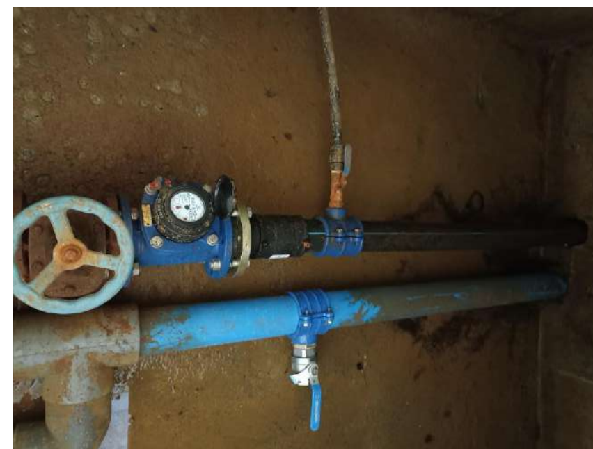
Figura 11. Comptador de Travesseres
