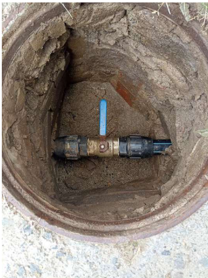
Figura 1. Arqueta circular, amb clau de pas blava.
