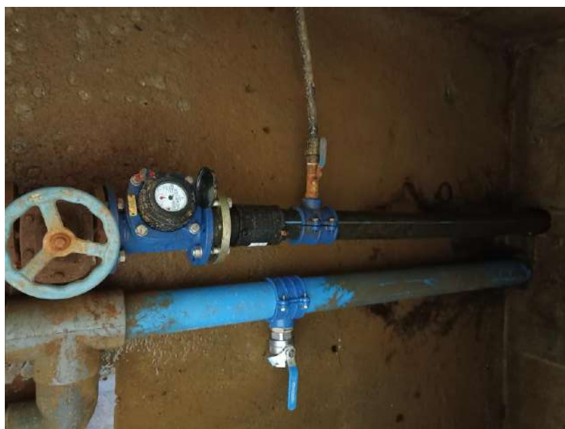
Figura 13. Comptador de Travesseres
