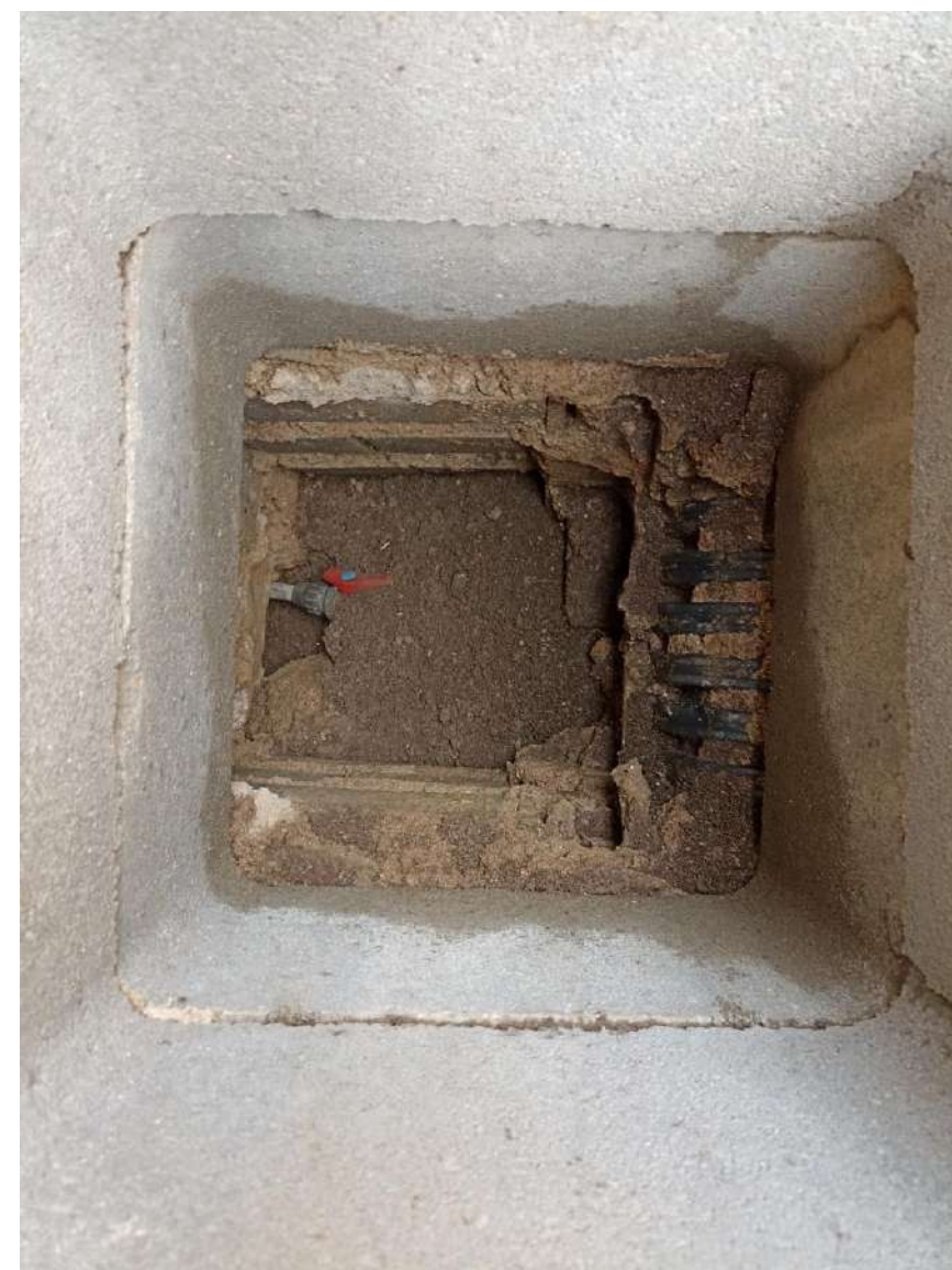
Figura 4. Arqueta amb la canonada soterrada.
