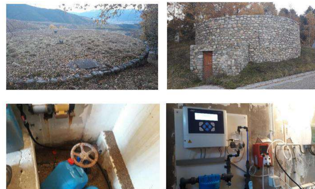
Figura 6. Infraestructura del Dipòsit de Lles.
