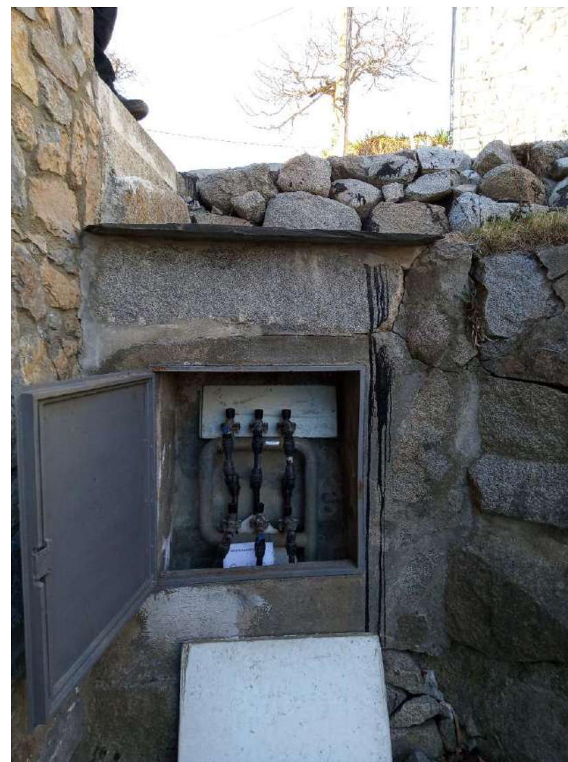
Figura 4. Arqueta tipus exterior, encaixada sobre un mur.
