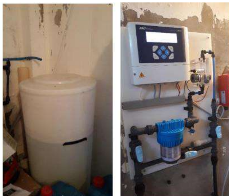
Figura 2. Estació de desinfecció del dipòsit de Lles.
