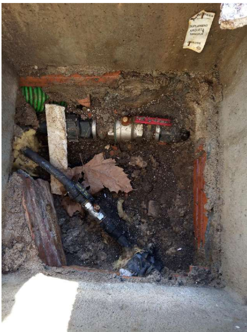
Figura 3. Arqueta tipus exterior. Vista de l'interior.
