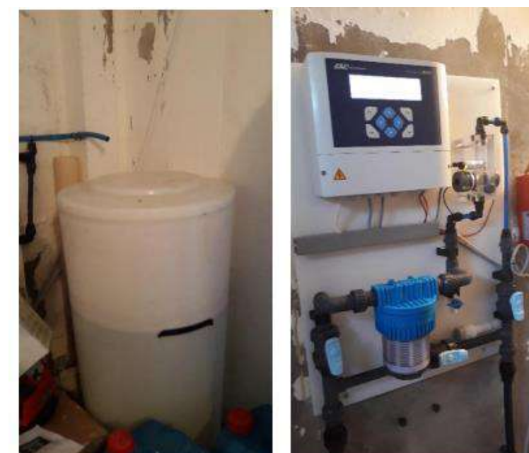
Figura 7. Estació de desinfecció del Dipòsit de Lles.
