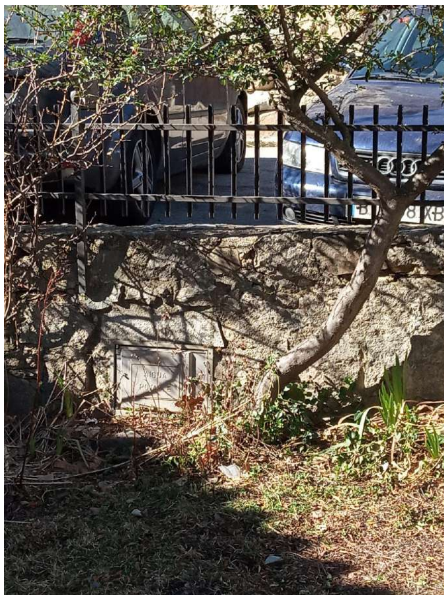
Figura 5. Arqueta tipus interior, al jardí d'un habitatge.
