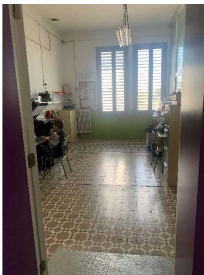
Despatx planta primera, amb un desnivell d'uns 8cm respecte el passadís
