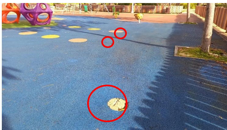
3 forats a reparar amb cautxú
