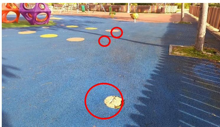
3 forats a reparar amb cautxú
