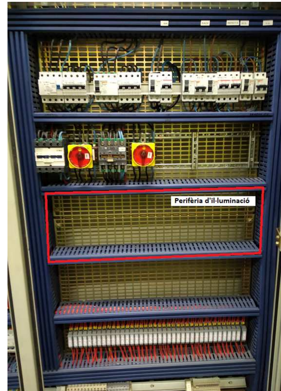
Mòdul 6 de l'armari d'enllumenat
