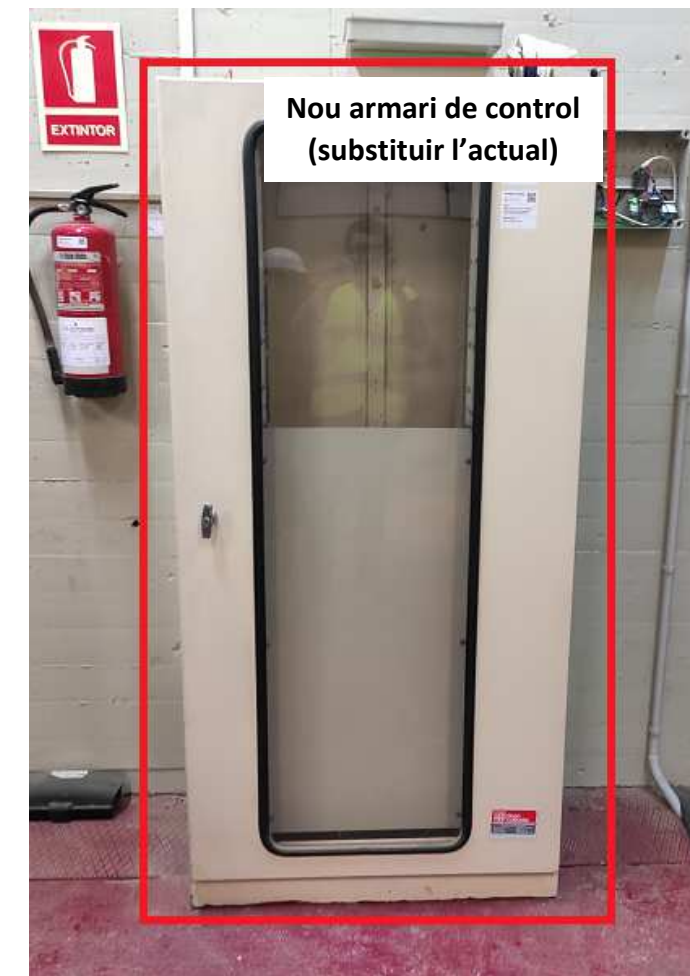
Ubicació del nou armari de control
