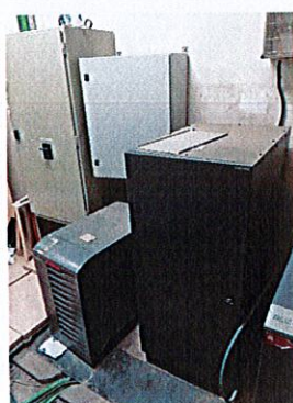
Foto 7 – SAI I EXTENSIÓ BATERIES GENERAL RADIOLOGIA
