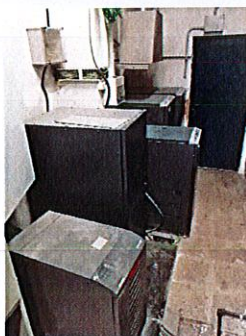
Foto 8 – SALA Tècnica amb SAI's Generals i Altres
