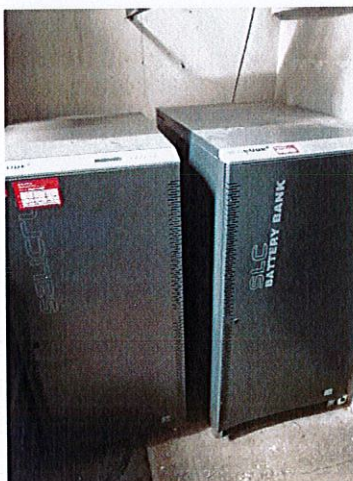
Foto 3 – SAI i Extensió bateries General
