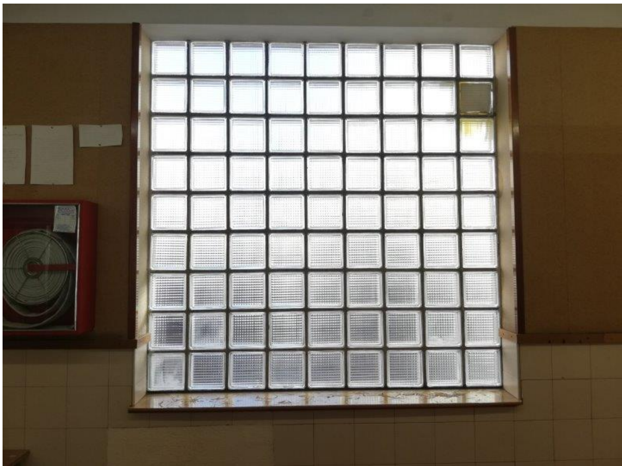
Mòdul d'obertura tipus, pavès no practicables i peces trencades
