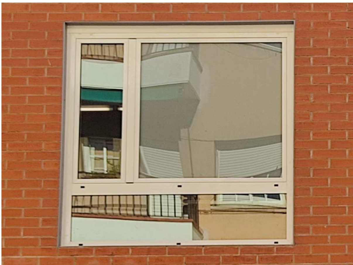
Detall de finestra superior amb emmarcat de passamans d'acer com a remat de l'obra
