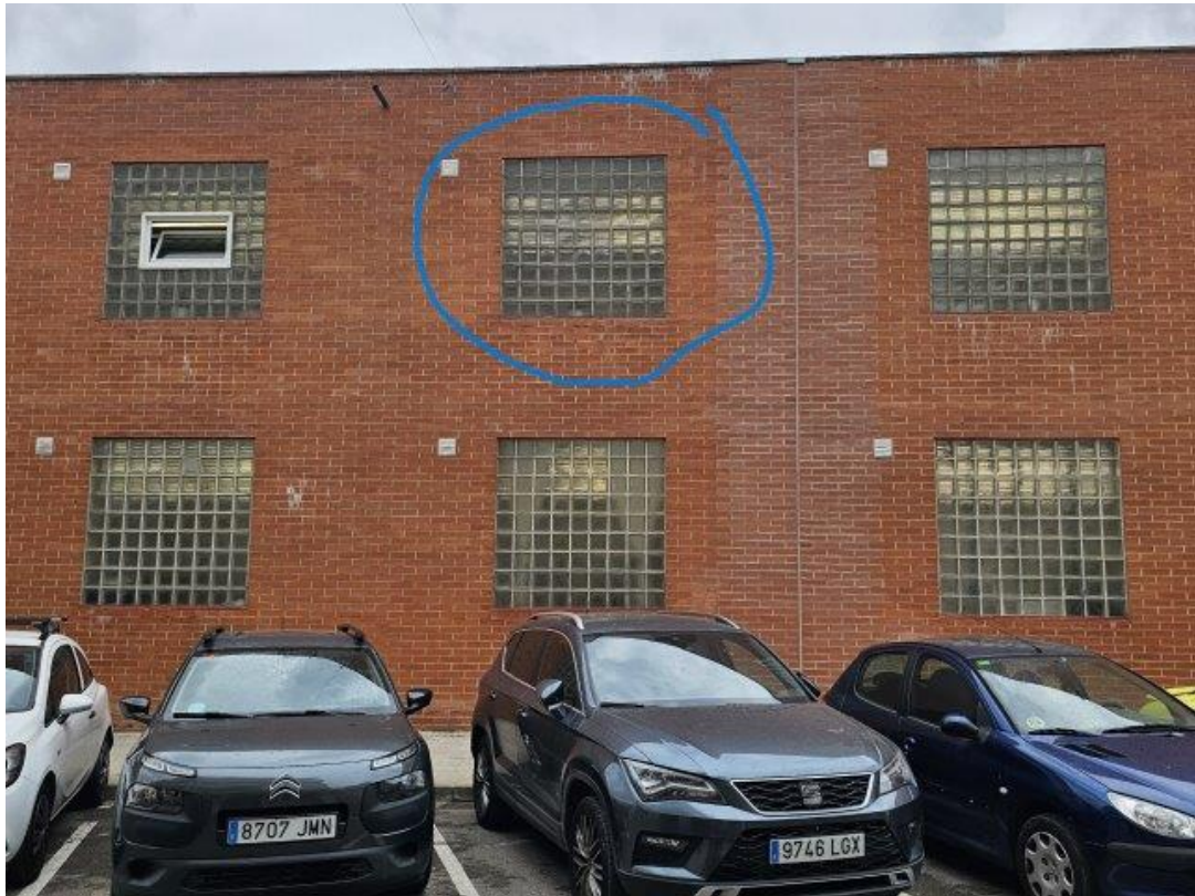
Imatge de desplom puntual de la façana
