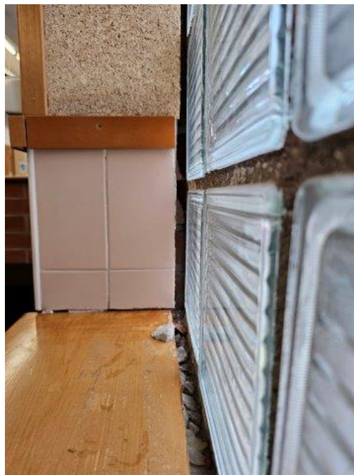
Imatge del parament exterior desplaçat respecte brancals i arrambador Vista des de l'interior
