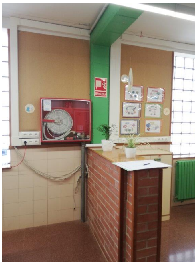
Imatge instal·lacions contra incendis i línies elèctriques i telecomunicacions
