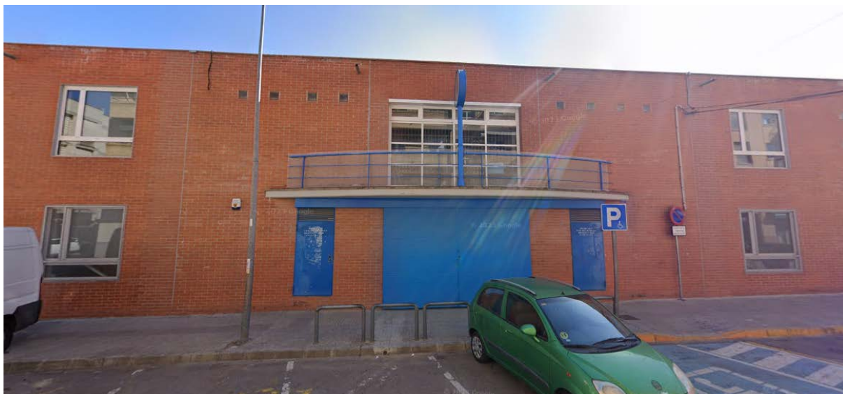
Imatge façana amb les 4 finestres canviades
