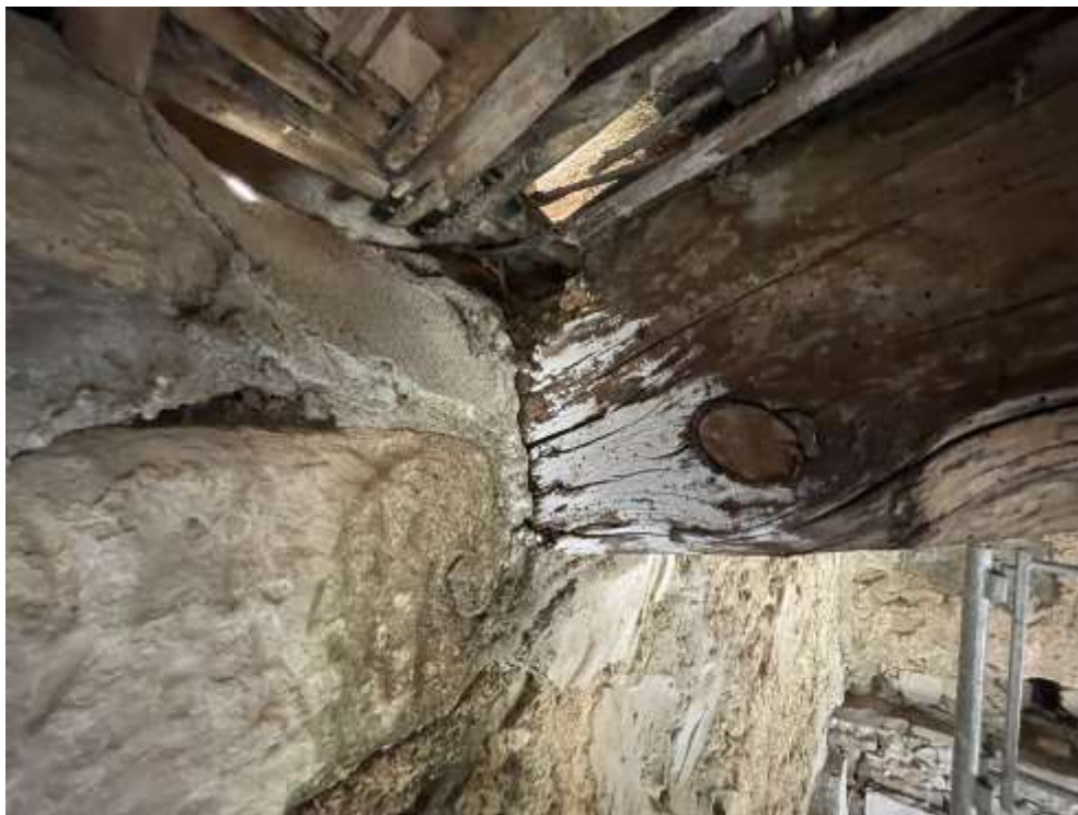
Fot 4: Fotografia actual de l'estat de les bigues de fusta de la coberta
