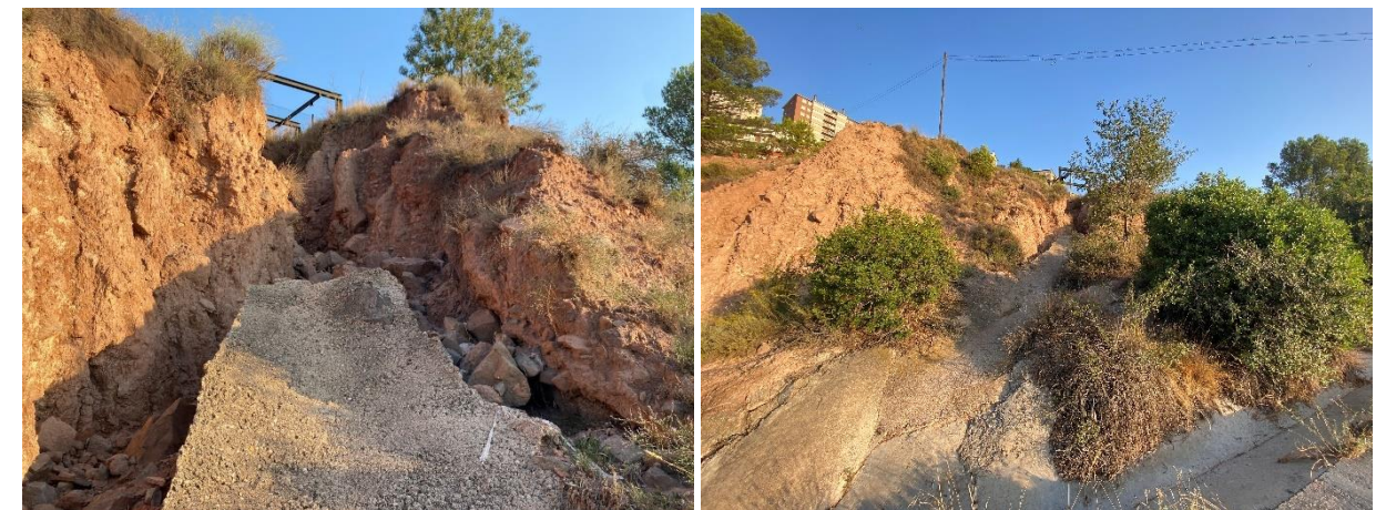
Figura 3. Estat actual del talús erosionat a la part sud del recinte de l'EBAR
