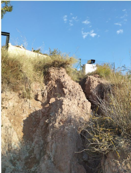
Vista de l'erosió.
