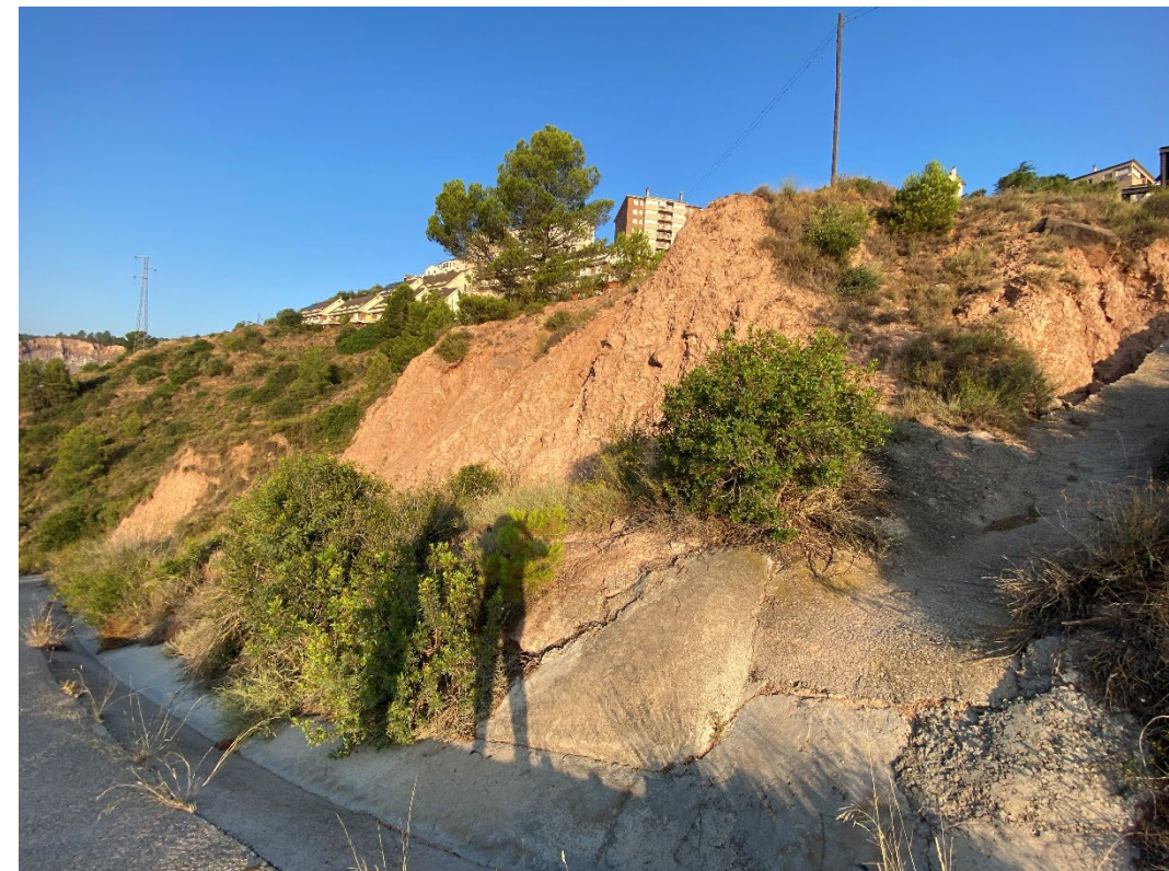
Fotografia núm. 8. Vista talús erosionat
