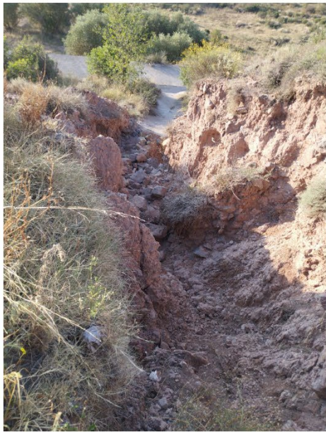
Erosió del talús vist des de dalt
