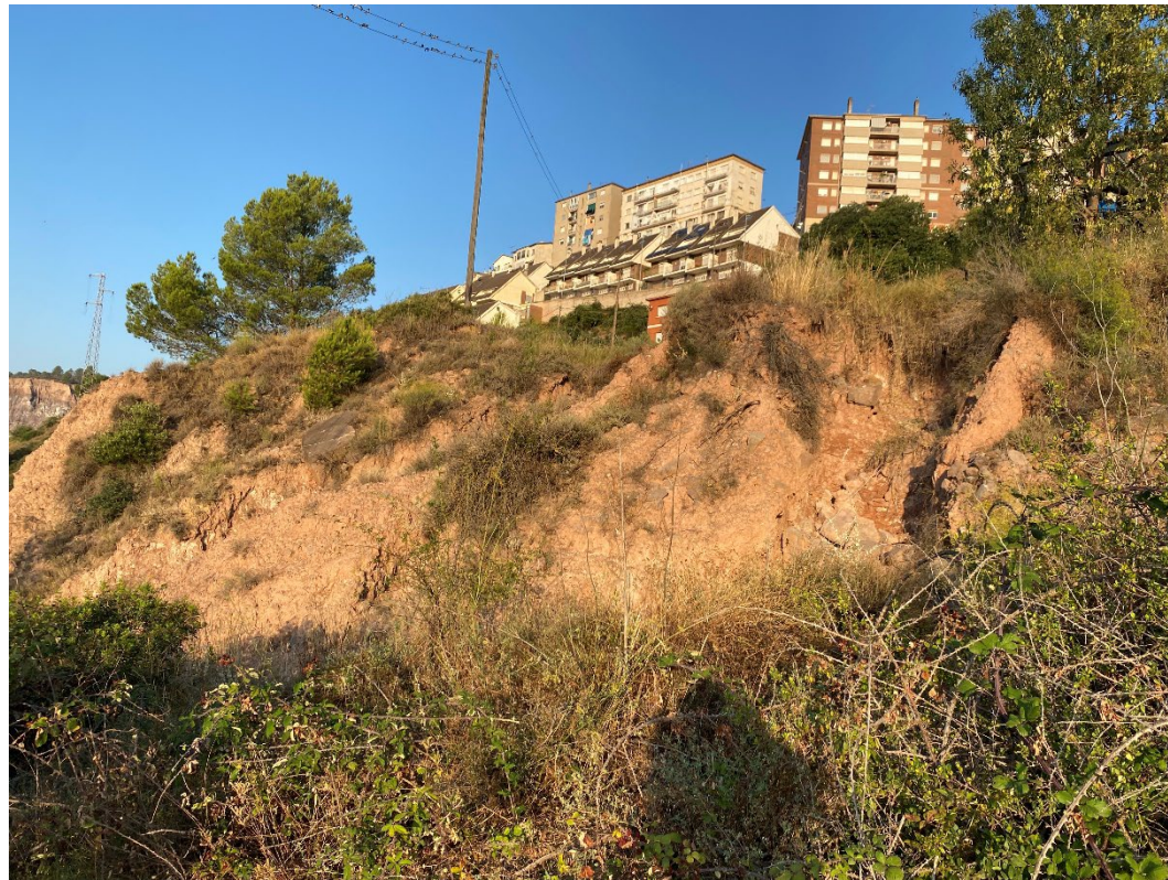
Fotografia núm. 5. Vista talús erosionat des de fora de la parcel·la on es situa l'EBAR
