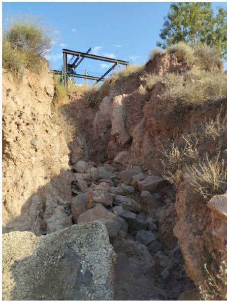
Erosió del talús vist de baix.
