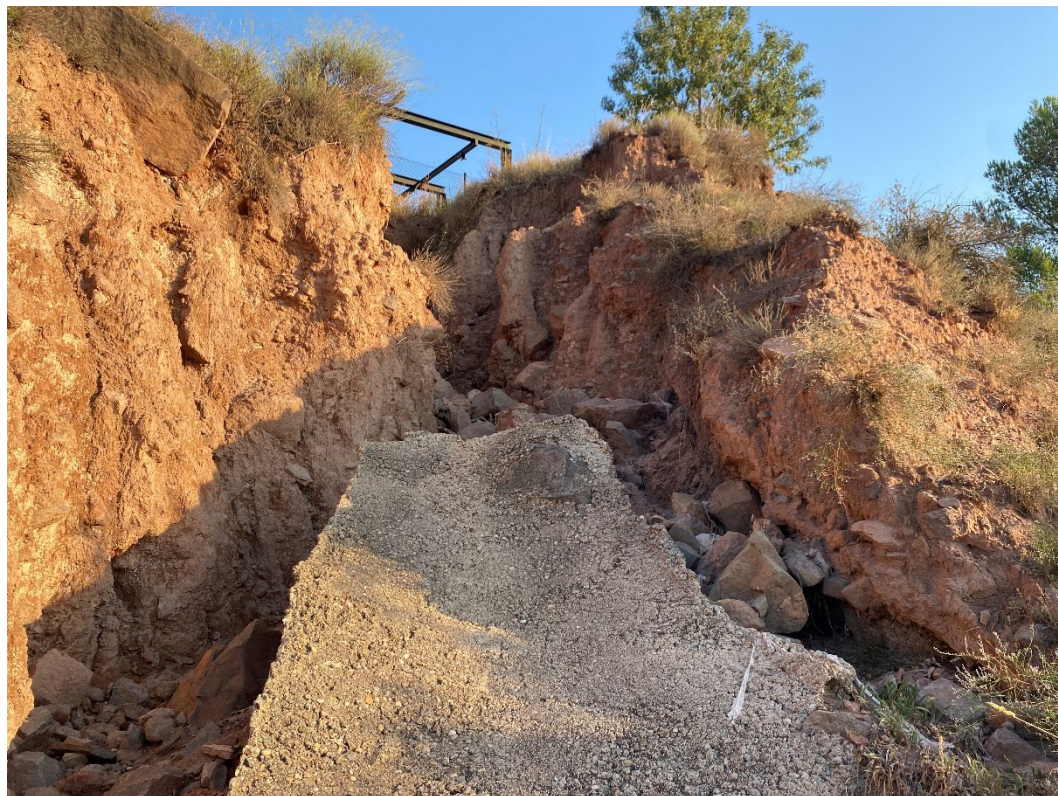
Fotografia núm. 10. Detall taús erosionat
