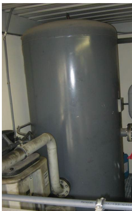
Figura 7. Dipòsit d'aire comprimit
