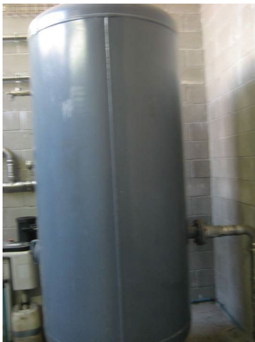
Figura 7. Dipòsit d'aire comprimit
