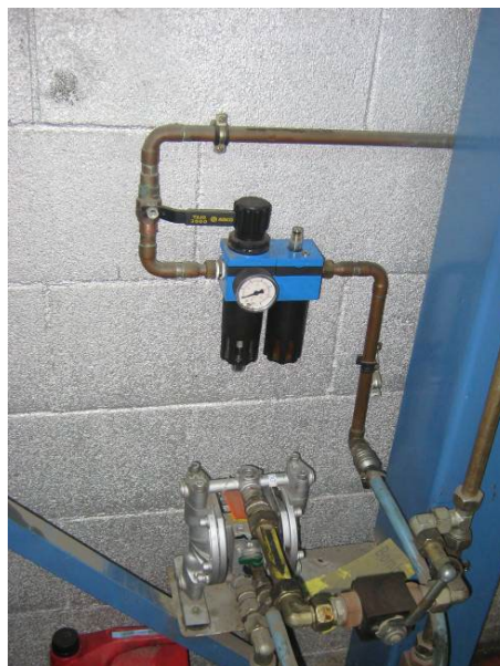
Figura 4. Unitat de manteniment.
