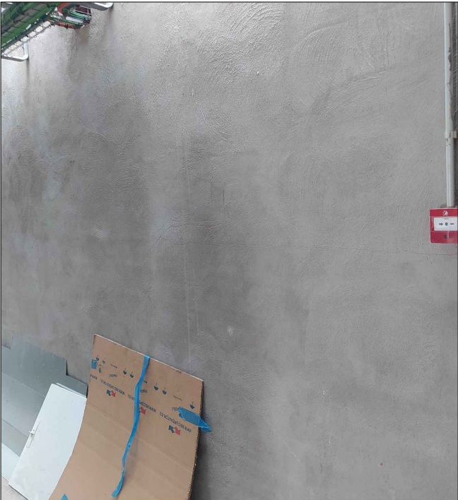
Imatge 2.- Zona Emplaçament armaris i inversors FV
