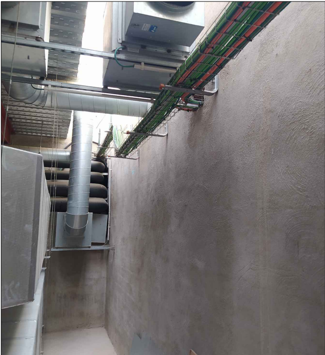
Imatge 1.- Zona Emplaçament armaris i inversors FV
