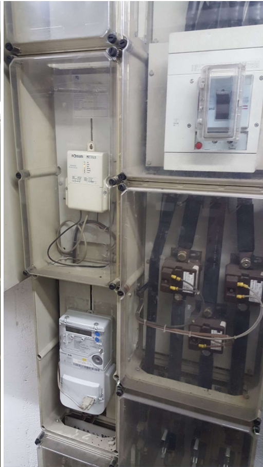
Imatge de la TMF de la climatització
