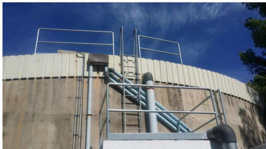
Fotografia 4 Dipòsit d'Idiada, detall de l'entrada dels pous
