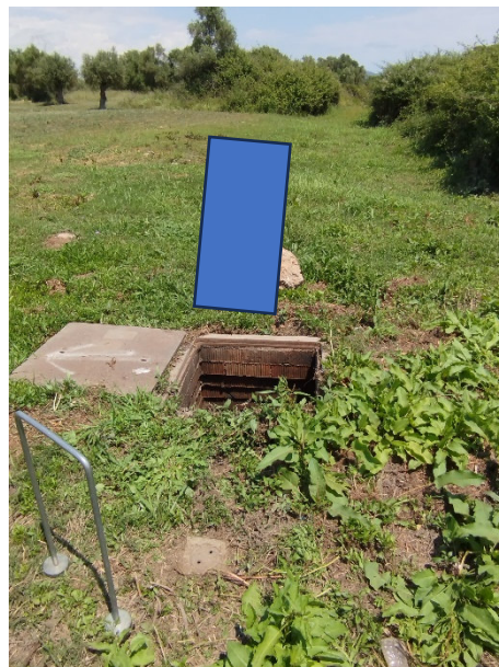
Fotografia 25 Ubicació arqueta sectorització distribució general polígons Molí d'en Serra i Torrent del Lluch
