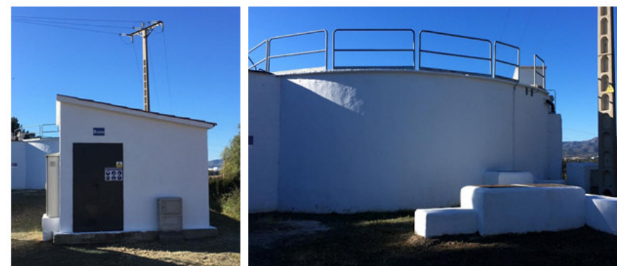
Fotografia 6 Esquerra: Caseta de bombeig del dipòsit Intermig. Dreta: Vista exterior del dipòsit Intermig
