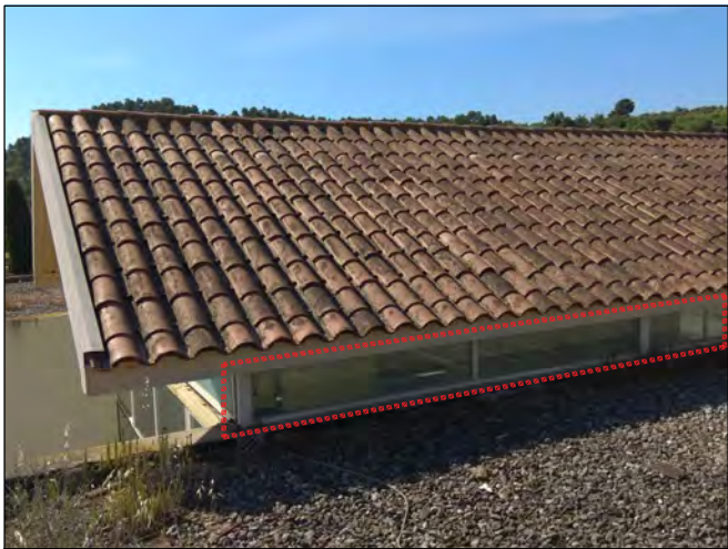
Finestres de la planta coberta a substituir.
