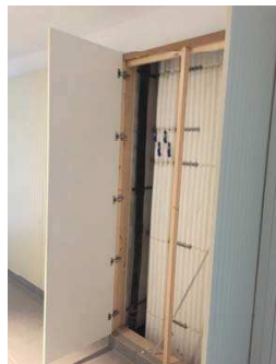
Armari de registre de la instal·lació d'aigua al vestíbul de cada planta.
