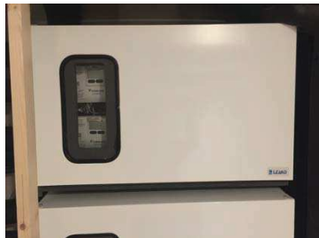
Caixa de regulació i comptatge de l'habitatge
