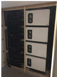
Armari de registre de la instal·lació de climatització al vestíbul de cada planta.
