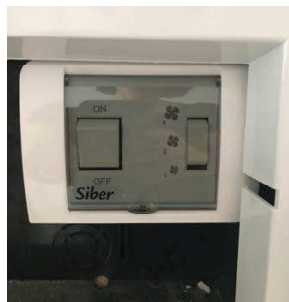
Comandament de control del ventilador d'extracció
