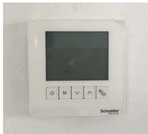
Termòstat situat a la sala d'estar.
