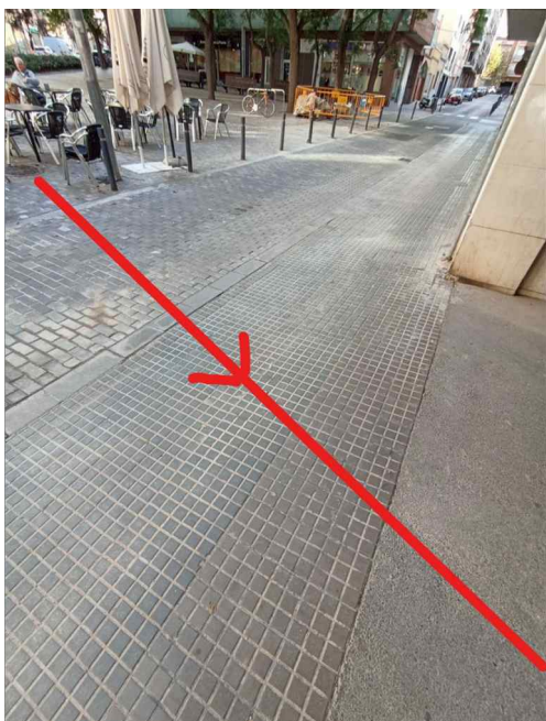
Vista zona accés i vorera amb lleugera deformació, indicant en vermell el traçat del col·lector
