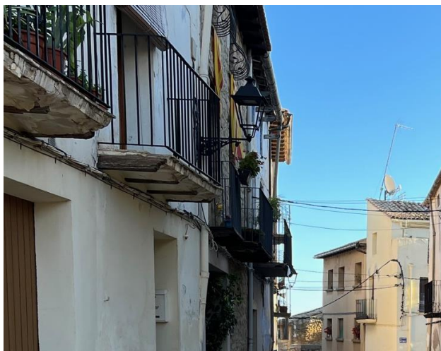
Foto Núm. 9 Fanal de la xarxa d'enllumenat on s'ha de substituir el cablejat aeri per un de subterrani per alleugerir les façanes del pas de cablejats aeris
