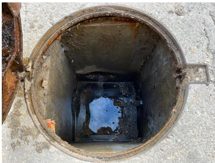
Fot. núm. 2: Vista de l'interior d'un dels pous de registre de la xarxa de sanejament on s'aprecien els tubs existents de formigó
