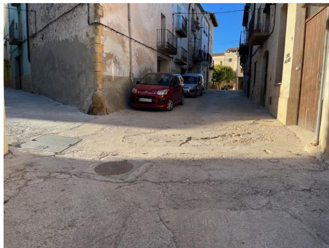
Foto Núm. 4 Intersecció del c/ Lluís Companys amb el c/ Francesc Macià i el c/ de Sant Domènec i 3 er pou de registre de la xarxa de clavegueram a renovar
