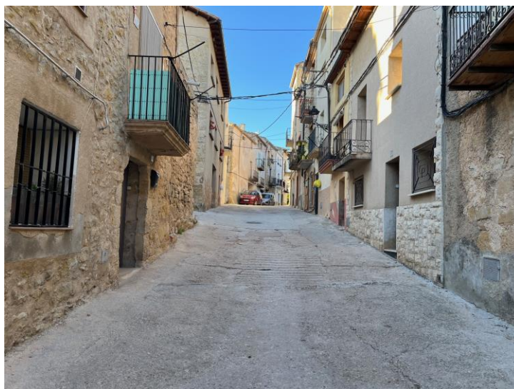
Foto. núm. 1: Vista del paviment en mal estat degut al deteriorament del pas del temps
