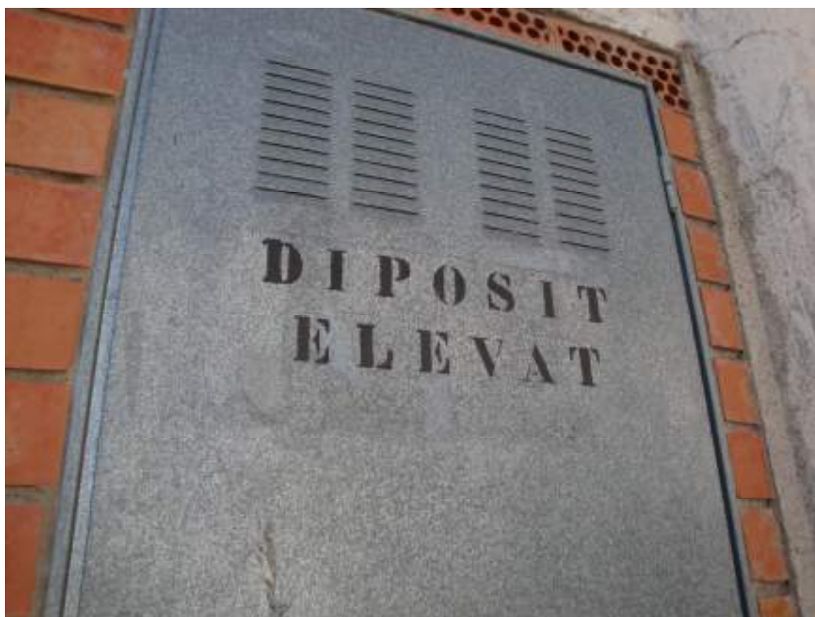
Fotografia 64: Porta local instal·lació aigua potable sota dipòsit elevat
