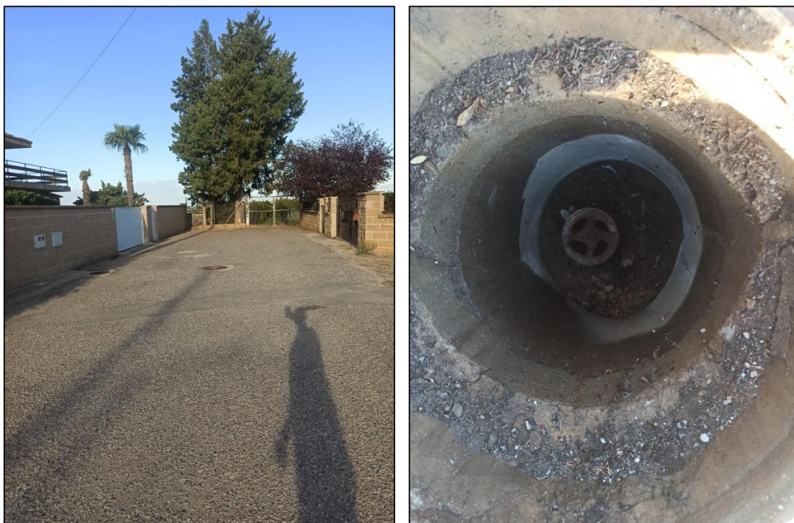
Figura 23. Estat del ferm a l'últim tram del carrer Eral de Dalt i últim punt de connexió (F5).
