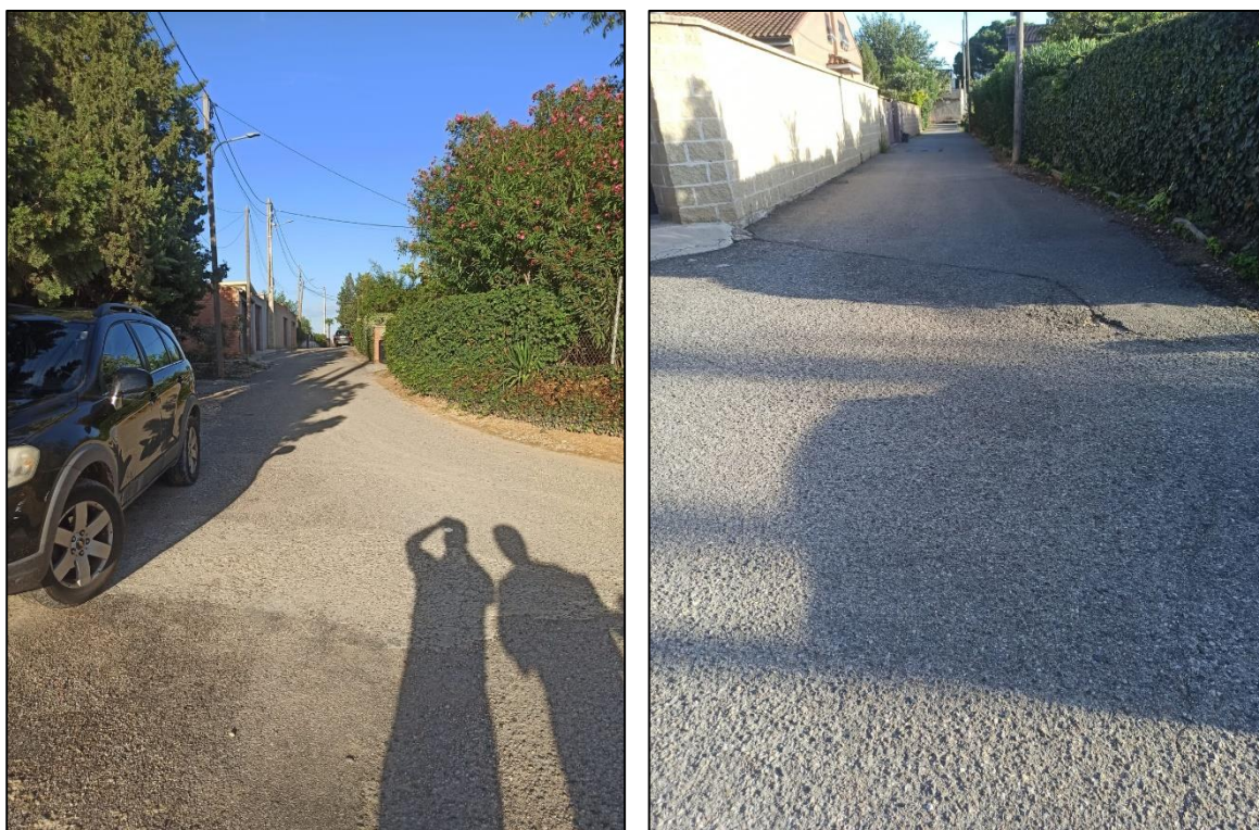
Figura 22. Estat del ferm en carrer eral de Dalt i camí eral de Dalt sense voreres (F4).
