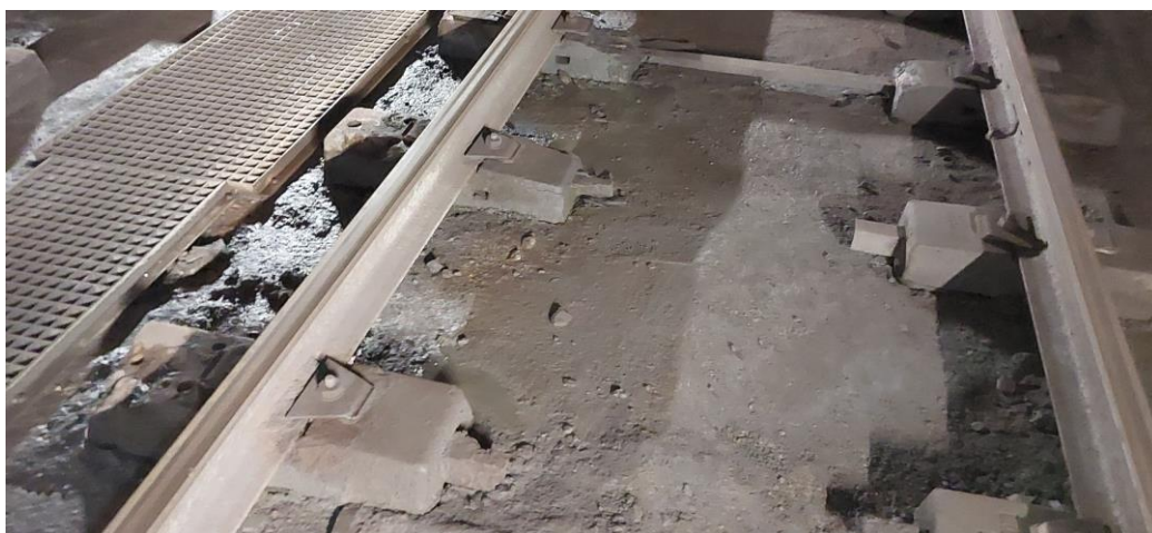
Imatge 2. Fotografia exemple travesses bibloc deteriorades
