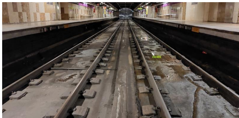
Imatge 8. Fotografia estat plataforma de via estació de Verneda sense drenatge a cel obert.
