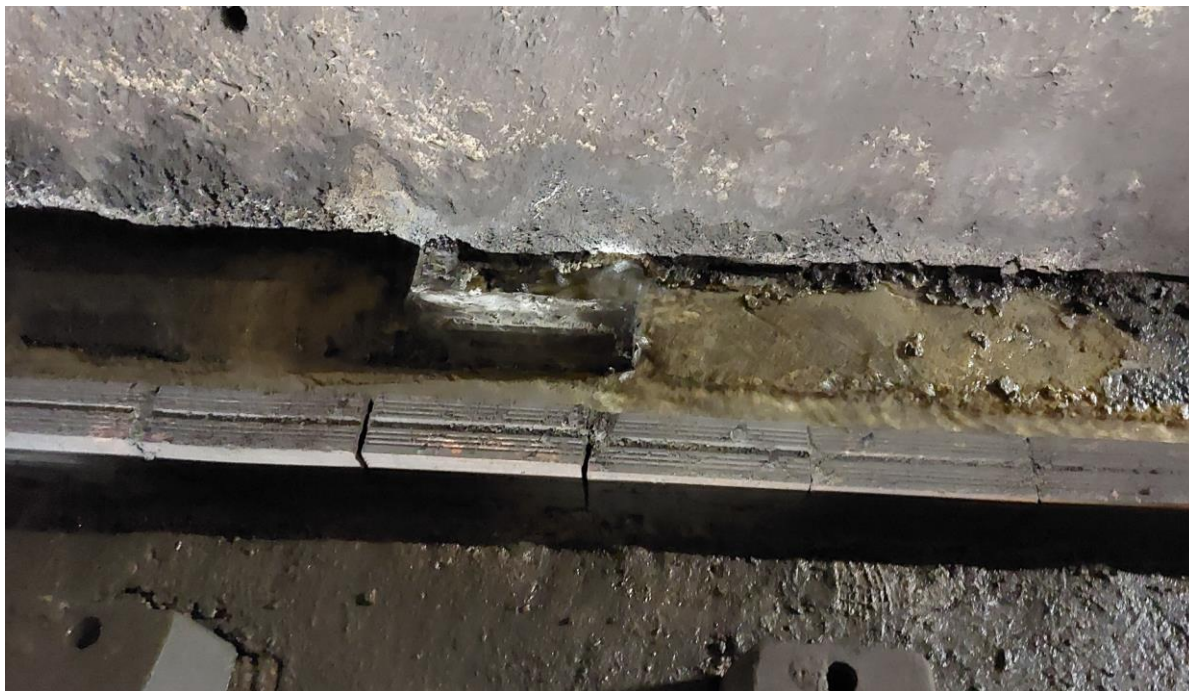
Imatge 15. Imatge filtració PK110+470 coincident amb tram via travesses STEDEF.
