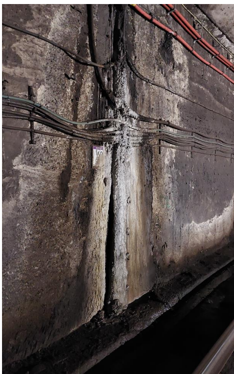
Imatge 13. Filtració PK110+900 hastial via 1
