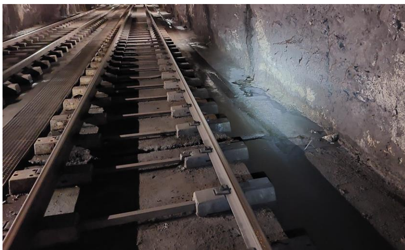
Imatge 9. Punt acumulació aigua al PK109+235 amb drenatge transversal insuficient.
