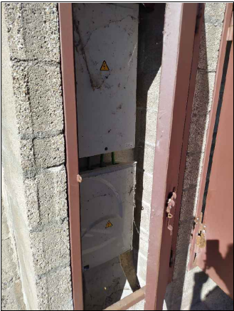
Imatge - Interior armari CGP
