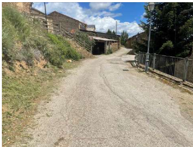
Imatge 05: Paviment asfàltic quarterat amb assentament sobre el traçat del clavegueram.
