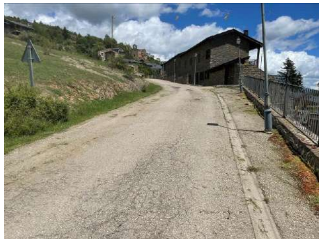
Imatge 02: Paviment asfàltic quarterat, encintat lateral de límit de calçada i bànculs de lluminària inclinats per assentament del sòl.
