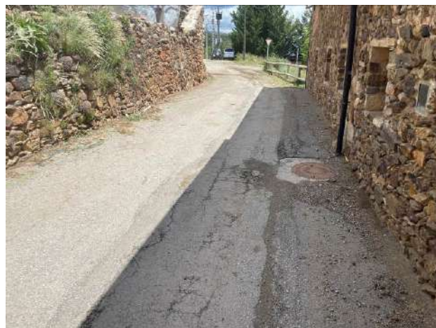
Imatge 10: Traçat de sanejament marcat per assentament de la plataforma.
