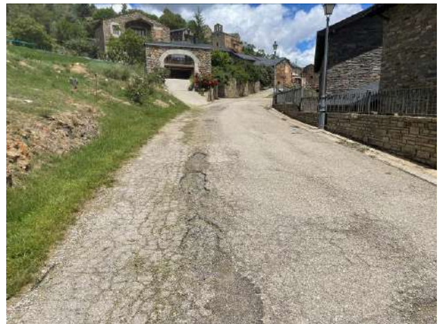
Imatge 02: Descrostonat i quarterament de capa superficial de paviment asfàltic.
