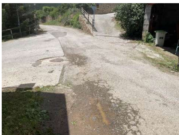
Imatge 07: Paviment asfàltic quarterat amb assentament de plataforma a la cruïlla amb el c. de Montcurtó.
