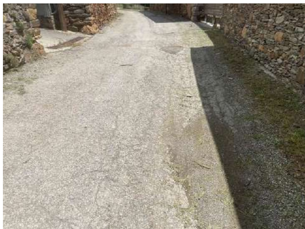
Imatge 09: Traçat de sanejament marcat per assentament de la plataforma.
