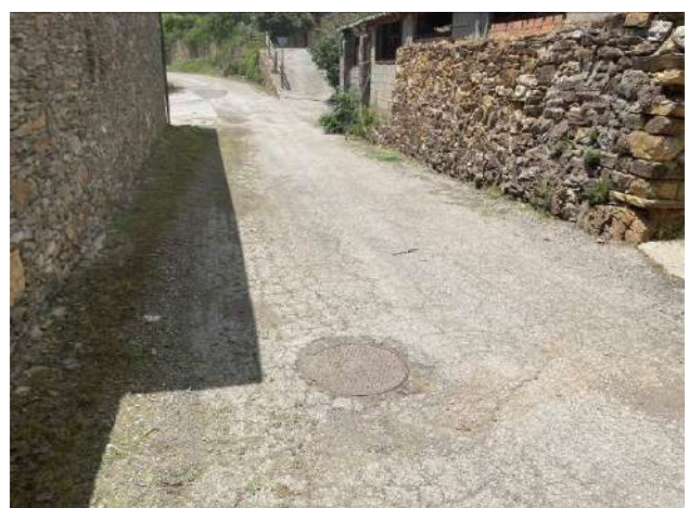
Imatge 08: Paviment asfàltic quarterat amb assentament de plataforma.
