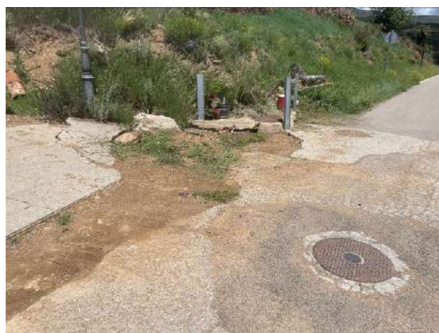
Imatge 14: Reixa interceptora del carrer de les Bassetes a reposar .
