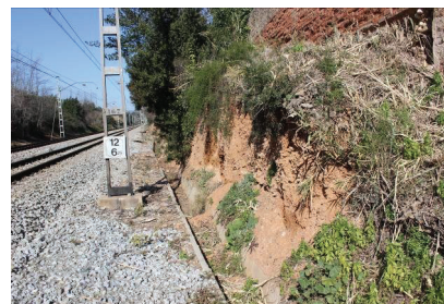
Foto n°1. Material erosionat acumulat a la cuneta.
