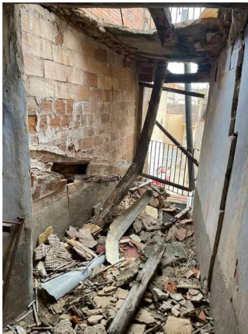
DF.11. Edificació el qual s'ha de consolidar l'estructura
