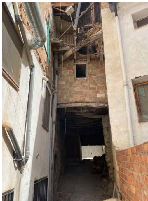
DF.6. carrer perpendicular al carrer de la Palma i edificació deteriorada.
