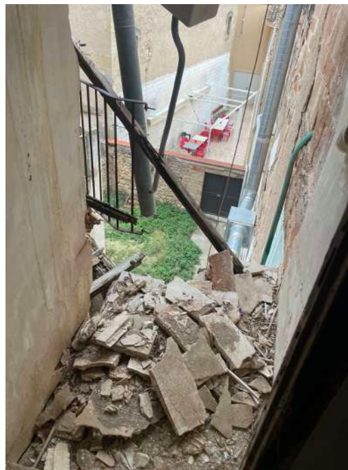
DF.10. Edificació el qual s'ha de consolidar l'estructura
