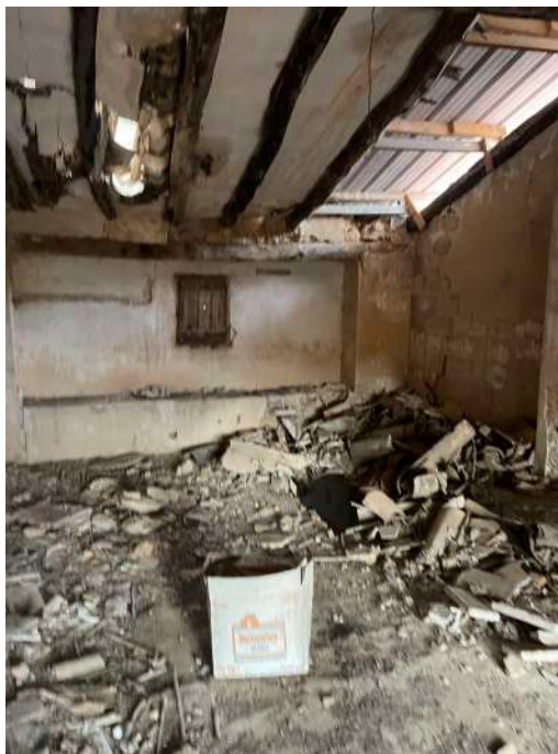
DF.9. Edificació el qual s'ha de consolidar l'estructura
