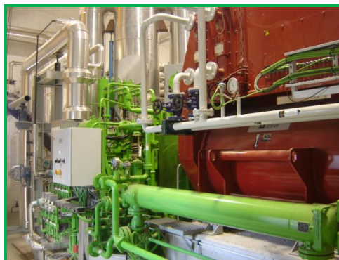
11. Turbina Siemens KKK
