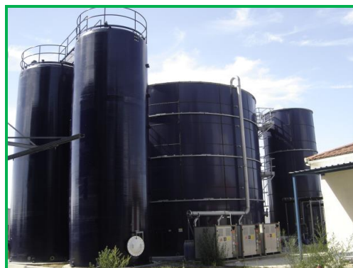
15. Depósitos del tratamiento de aguas
