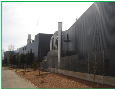
14. Tratamiento de aires (biofiltro/RTO)
