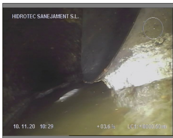
Foto: 4_2A, 00:00:36 0,5m, Acometida sobresaliente desde 03 hasta 04 horas, (sobresale 10 cm)
