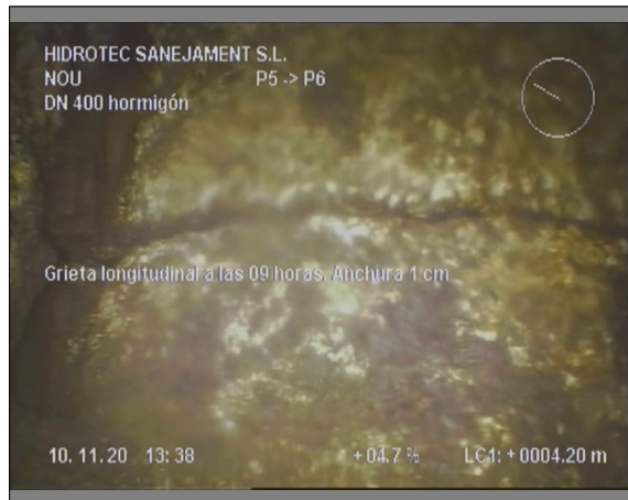
Foto: 9_2A, 00:01:12 4,2m, Grieta longitudinal a las 09 horas. Anchura 1 cm
