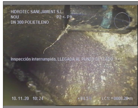
Foto: 3_3A, 00:02:28 8,2m, Inspección interrumpida
