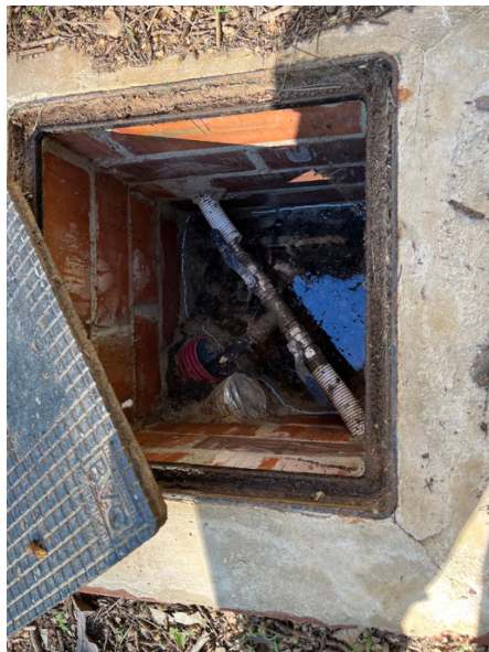
arqueta amb clau de pas
