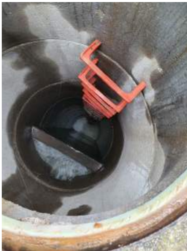
Imatge 6. Pou 33. Connexió punt final.
