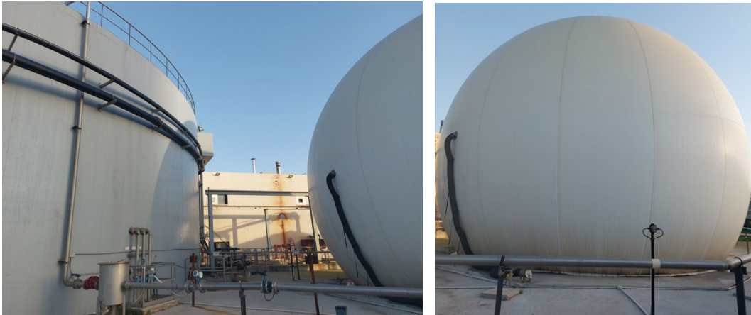
Sortida digestor i gasòmetre
