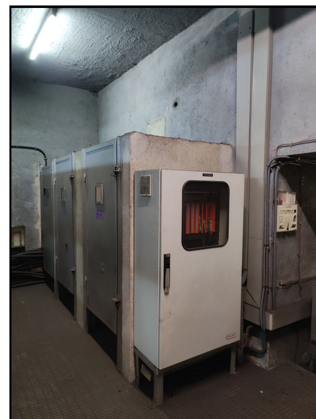
RTU dintre de la sala de seccionadors
