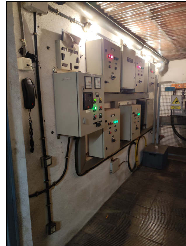
Adequació sala amb nou SQ-Maniobra i nou equip VLD
