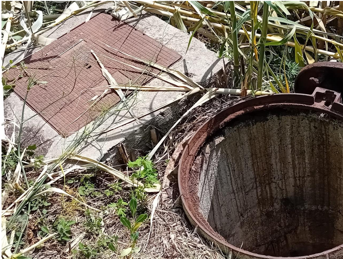
Fotografia 1. Pou del col·lector en alta i pou sobreeixidor
