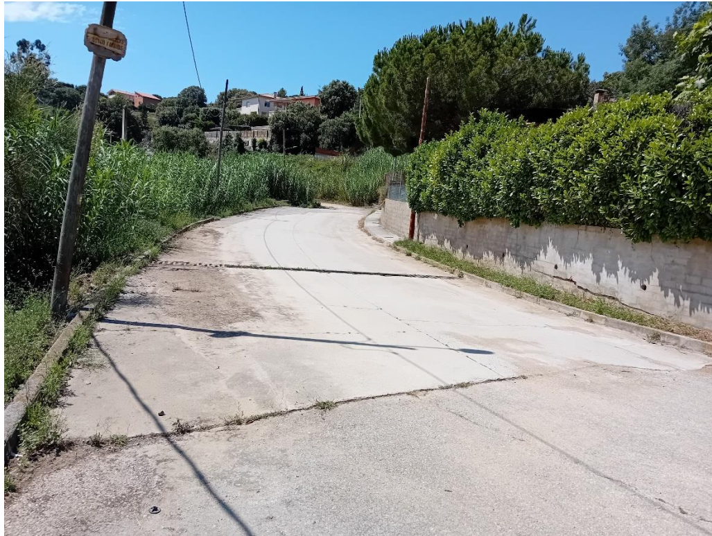
Fotografia 12. Reixa al carrer Osona aigües avall de la zona àmbit de projecte
