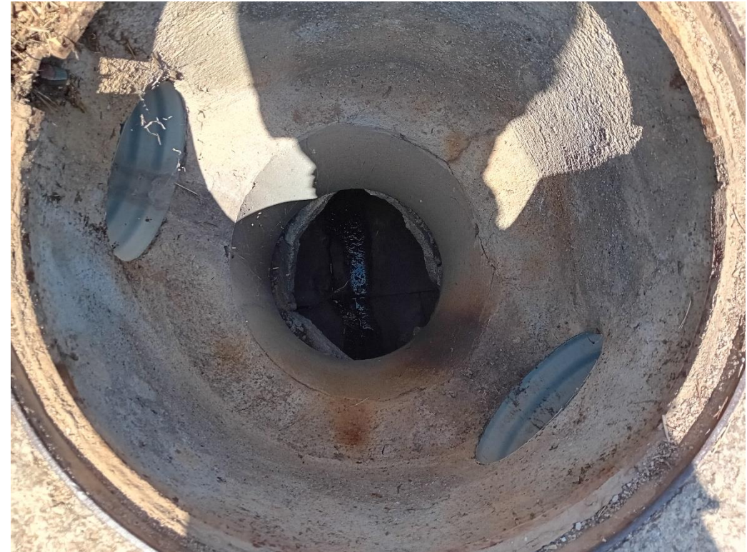
Fotografia 10. Interior pou 2280. Reixes carrer Bages
