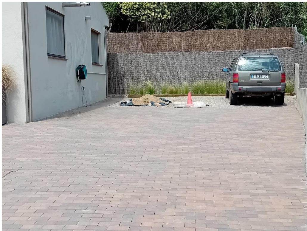
Fotografia 4. Esvoranc generat en finca privada
