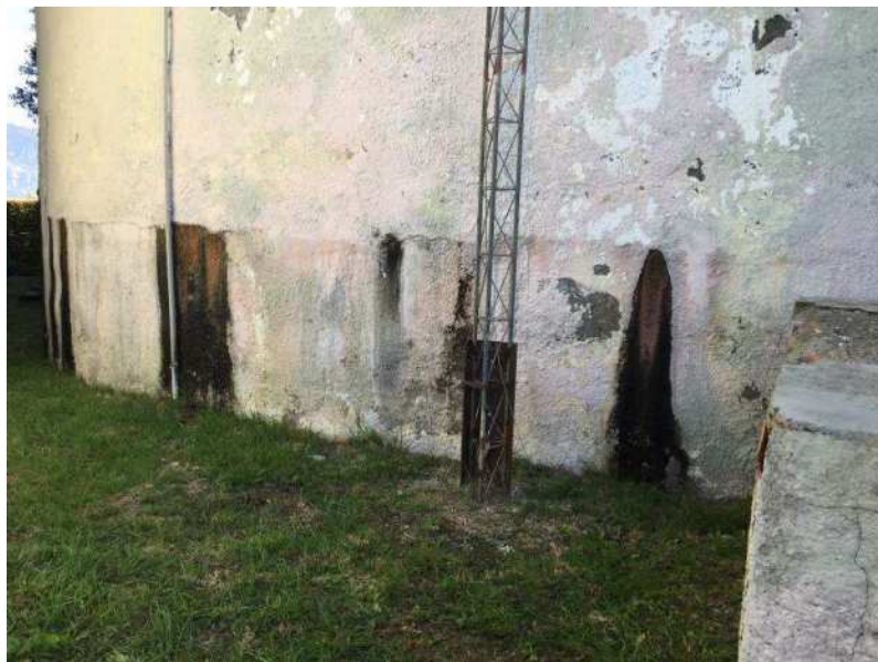
Fotografia 1. Nivell de fuites al dipòsit 2.
