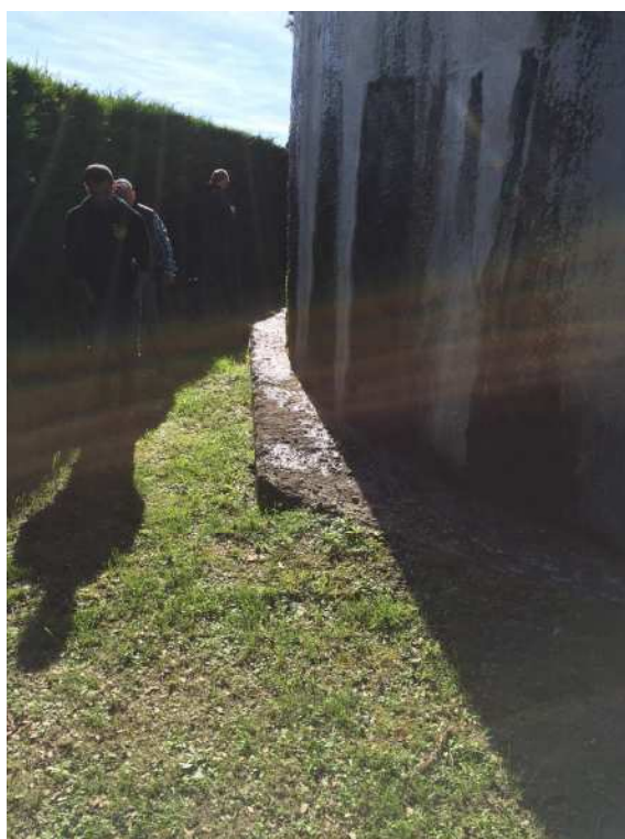
Foto 8. Pèrdues del dipòsit 2 en zona de poc espai de treball.
