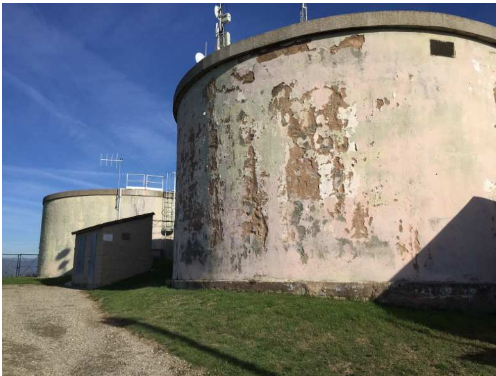
Foto 1. Dipòsits 1 i 3 del Pla de l'Aire
