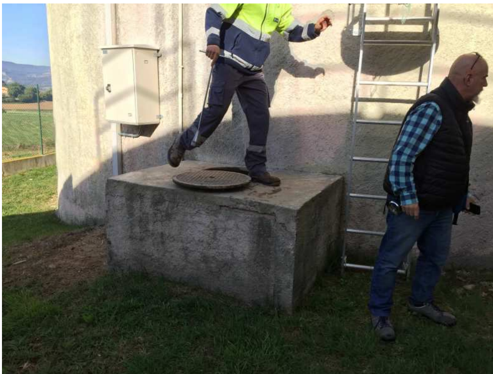
Foto 6. Arqueta sortida/buidats dipòsit 1.
