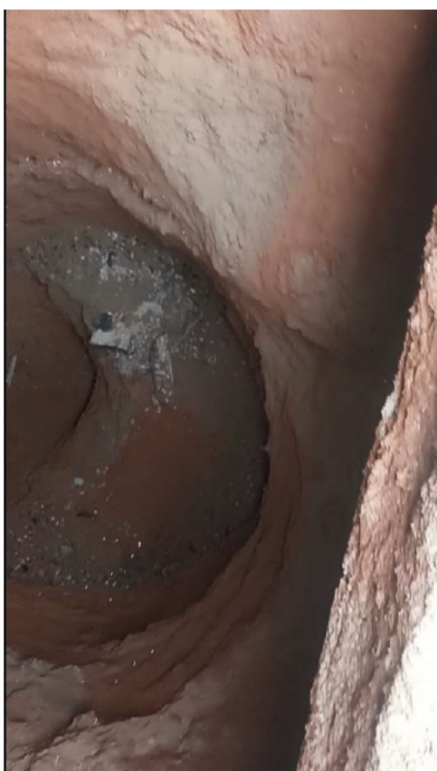
Vista de l'esvoranc des de la superfície
