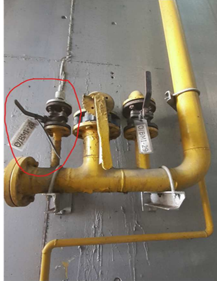
Figura 1. Escomesa de gas natural ja preparada per al pilot ABATE
