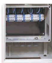
Espacio para conexiones
