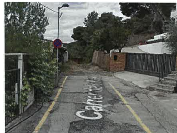
Imatge 2. Carrer dels Pins. Senyalització horitzontal a restituir i final actuació (StreetView).
