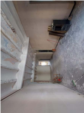
Part de l'estructura i coberta d'aquesta planta està apuntalada per l'estat deficient de l'estructura. Una part de la coberta, concretament a la part posterior, està esfondrada.
