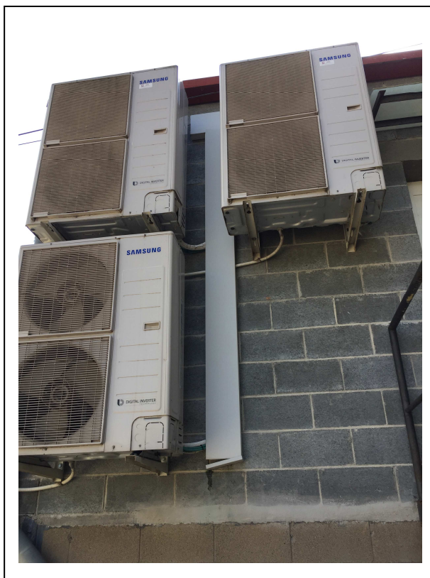
Foto 4. Bombes de calor existents del gimnàs actual.
