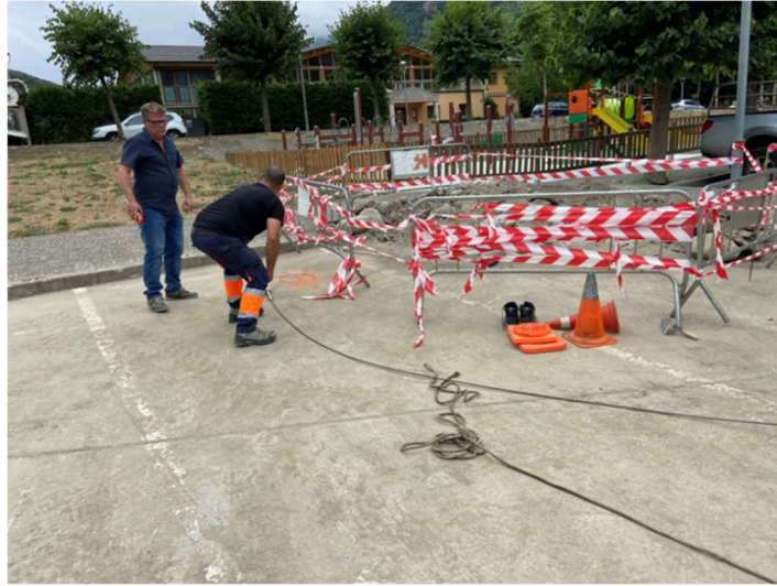
Imatge 4. Senyalització del final de la zona a reparar i inici del tram encamisat
