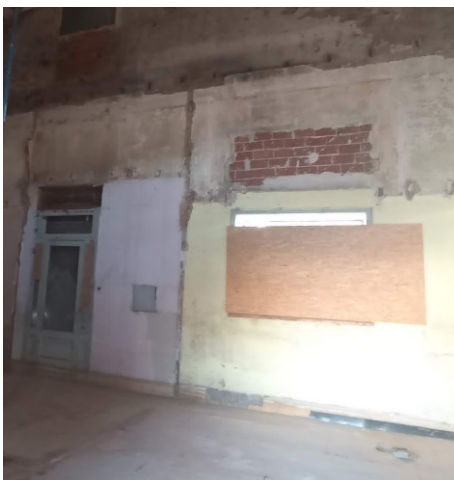
Proteccions amb fustes
