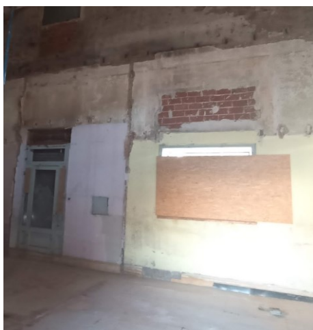
Proteccions amb fustes
