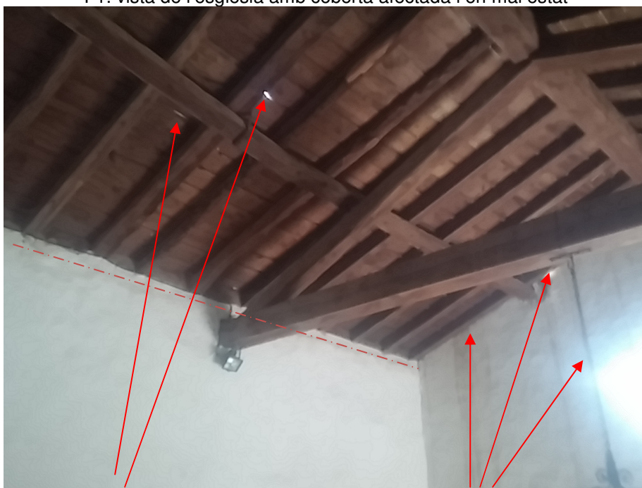
F2. Vista de la coberta interior amb entrada d'humitats.
