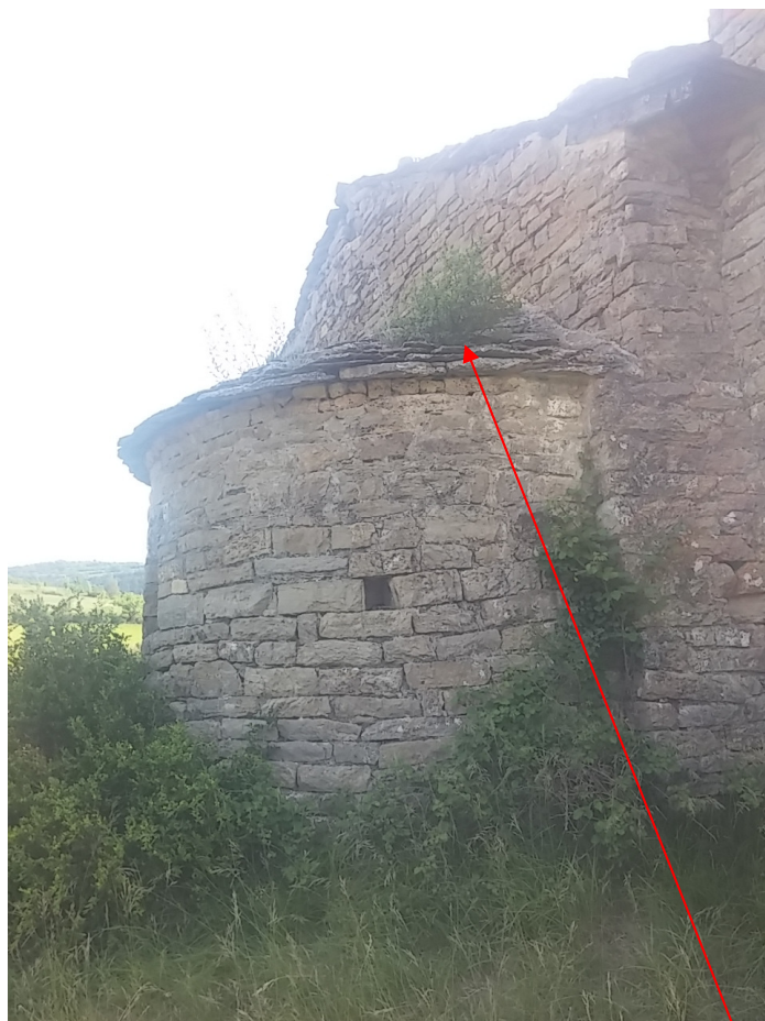
F3. Vista de la coberta de l'absis afectada per humitats i vegetació.
